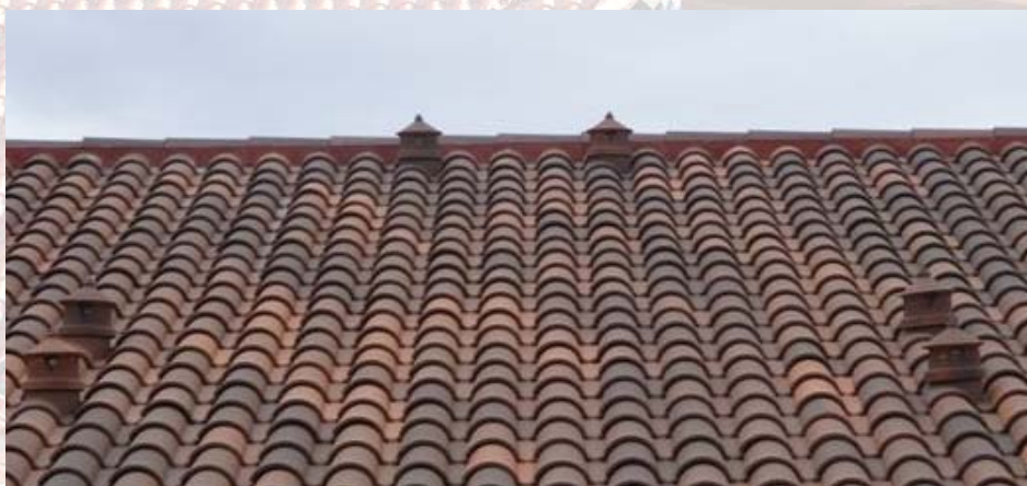
Fotografía 13. Chimeneas de ventilación. Posición desencontrada
