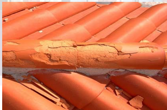
Fotografía 1 y Fotografía 2. Desconchados en teja cerámica por falta de microventilación
