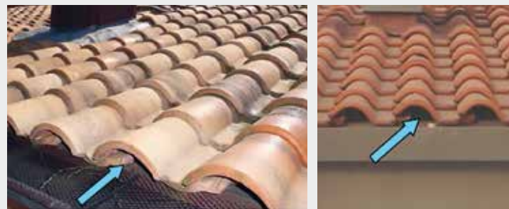
Alero libre para permitir la entrada de aire de la microventilación
