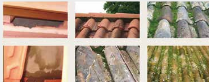
1. Condensaciones (ventilación insuficiente)
